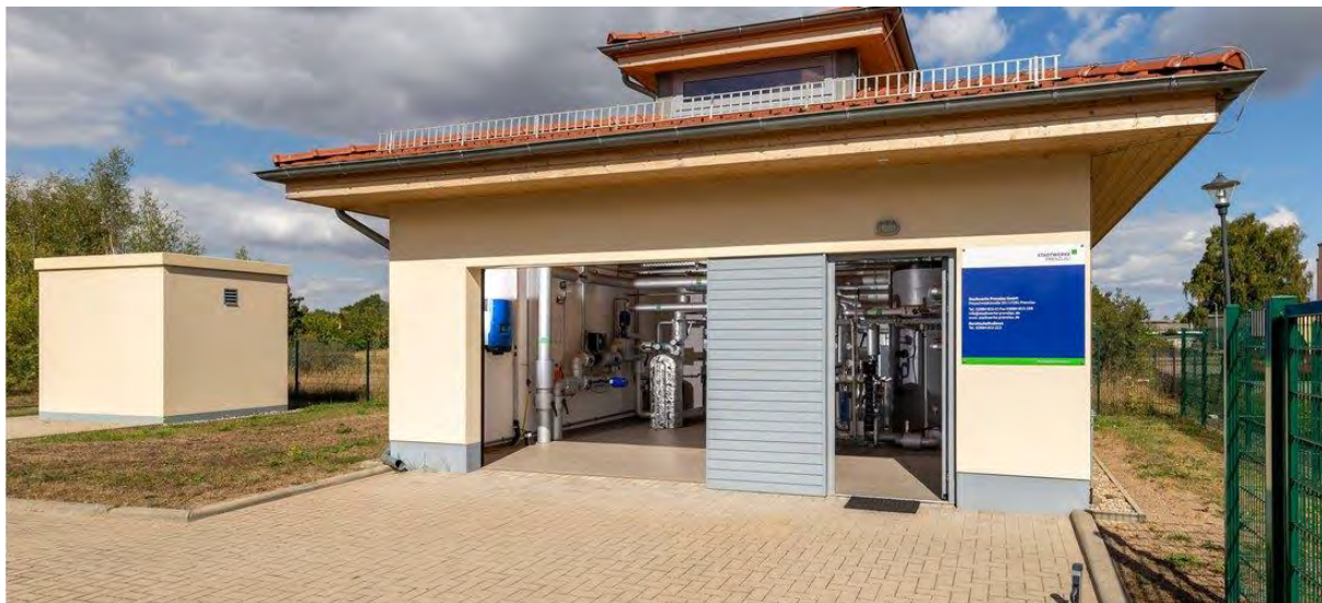
Obr. 42 – Povrchová stanice hlubokého výměníku tepla v Prenzlau (Německo). (Bestec GmbH).
